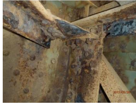
Acier remplacé en 1997 (17 ans) situé dans la zone d'éclaboussure
